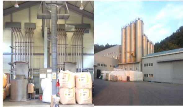
BASE SILO 저장 및 Mixing Room 이송
